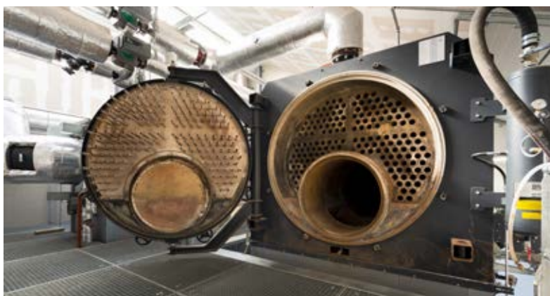
Chaudière à copeaux de bois de 1,7 MW therm. avec échangeur thermique + équipement de nettoyage pneumatique
